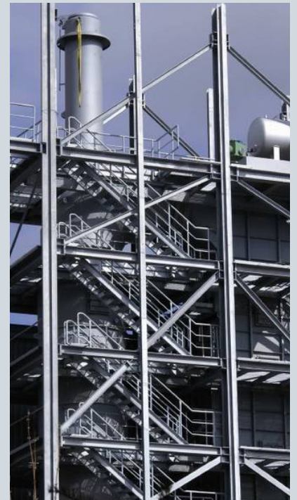
Die neue Trockenentstaubung im Werk Breidenbach der Buderus Guss GmbH
