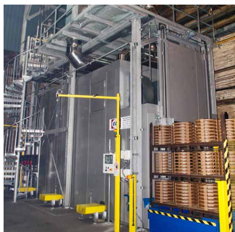
Der Kerntrockenofen nutzt die Abwärme aus dem Kupolofenprozess. Die Einsparung entspricht dem Erdgasverbrauch von vier Haushalten pro Jahr
